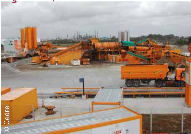
Planta de tratamiento construida para el lavado de sedimentos durante el vertido del Erika
