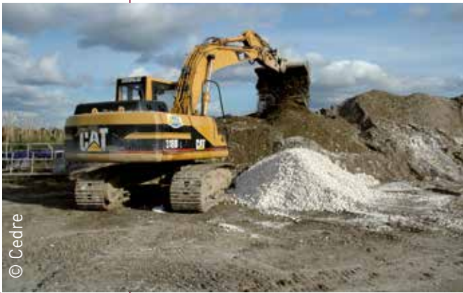
Sedimento oleoso estabilizado con cal viva
