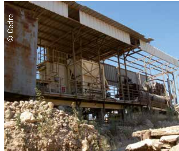
Equipo de desorción térmica in situ
