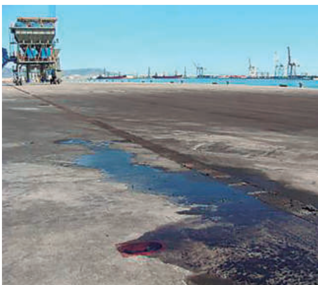
Drenajes cegados por restos de mercancía
