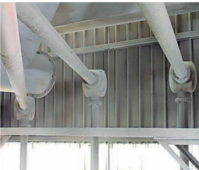
"Codos" en tuberías neumáticas
