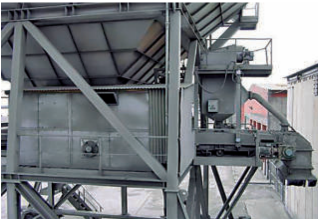
Aspiración en punto de transferencia de tolva a cinta
