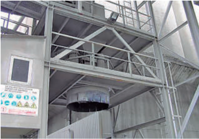
Control de emisiones en carga de camión mediante mangas con aspiración.
