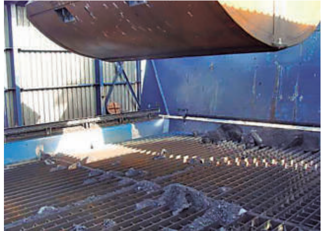
Pantallas en tolva de pórtico descargador protegiendo del viento la apertura de la cuchara.
