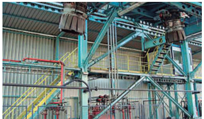
Cargador de vagones con dosificador de carga y varios puntos de carga por vagón.
