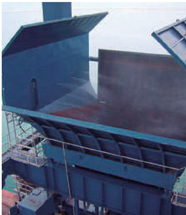
Tolva con pantallas y atomizadores. El tejado superior protege los inyectores.
