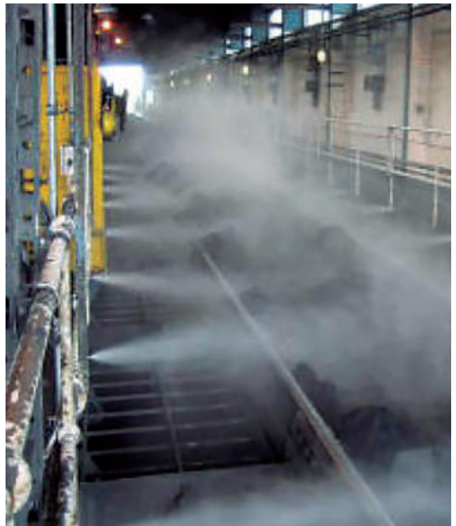
Descargador de vagones con nebulización de agua.
