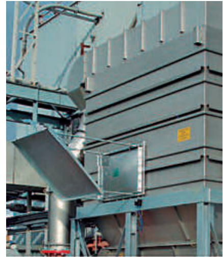
Panel de rotura y deflector en filtro
