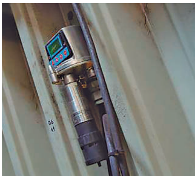
Detectores de gases combustibles.
