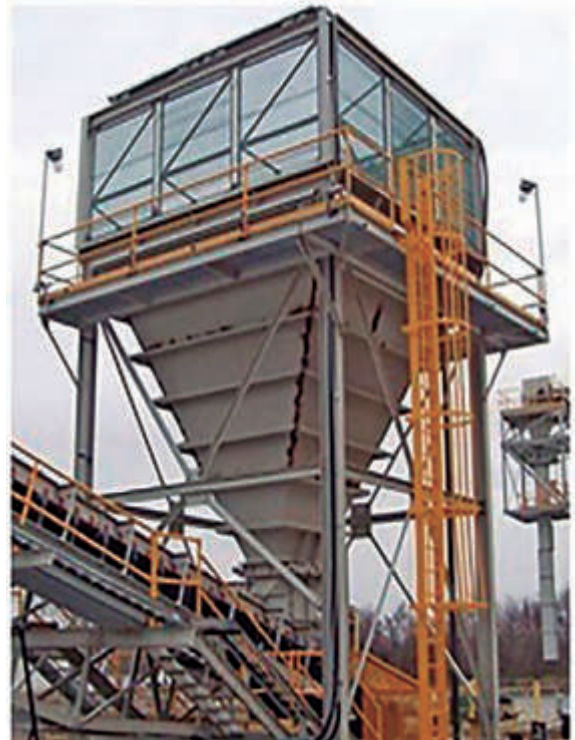
Boca de tolva apantallada con malla porosa para evitar turbulencias y nebulización
