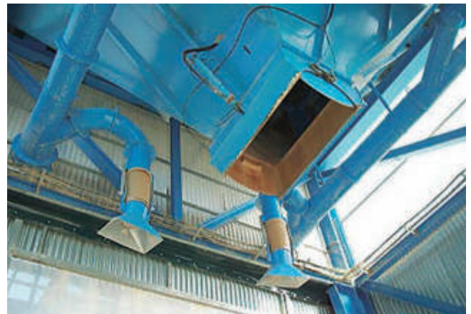
Tolva con zona de carga de camiones carenada y aspiración en el recinto
