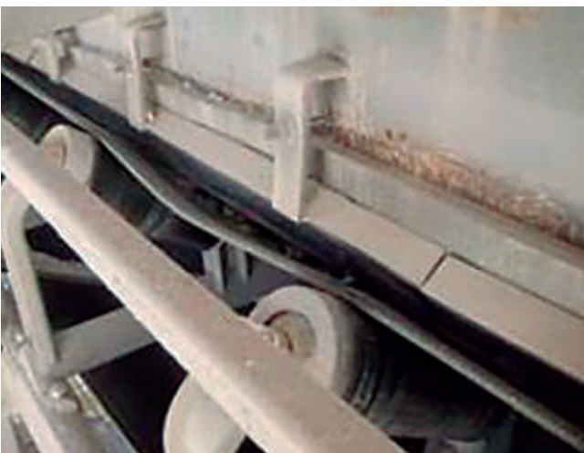
Rodillos muy separados en zona de carga y formación de sacos en la cinta.
