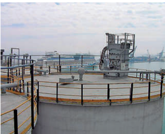
Sistema de aspiración y filtrado del venteo de un conjunto de silos
