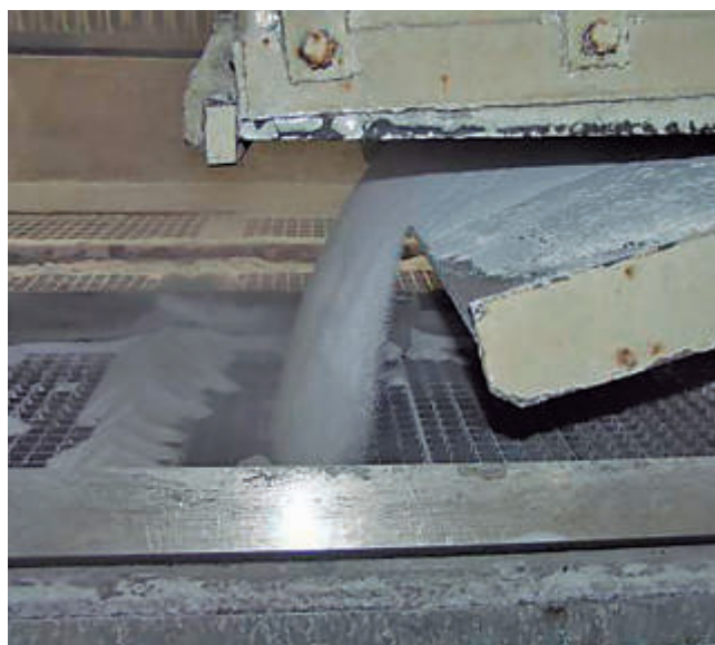
La aspiración permite controlar las emisiones de polvo en la descarga.
