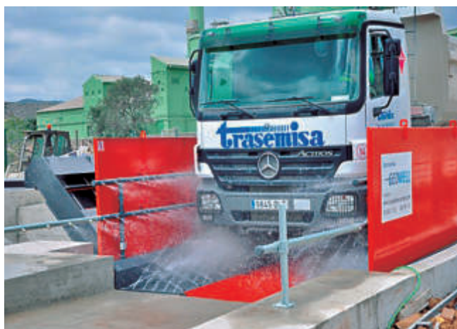
Sistema lavaruedas en funcionamiento
