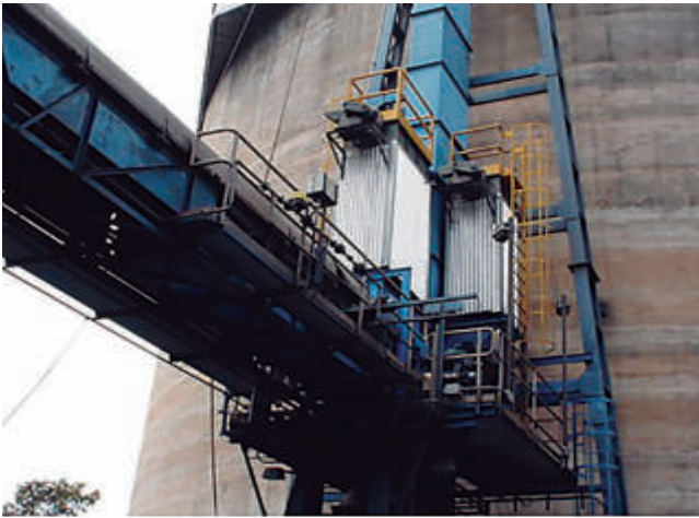
Filtro insertable en transferencia de cinta a elevador de cangilones.
