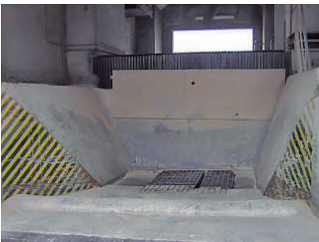
Tolva de descarga para camiones, en recinto cubierto
