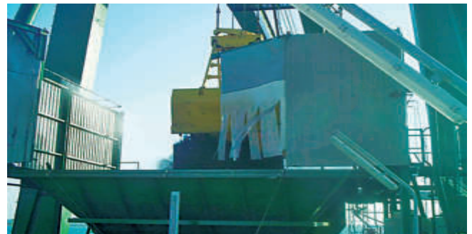
Inyectores de agua pulverizada en tolva protegida por pantallas en un descargador.
