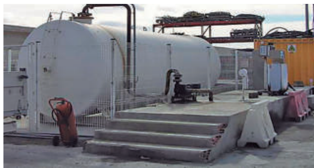
Los depósitos de combustible elevados sobre el suelo permiten detectar posibles fugas. Se instalan además cubetas en conexiones.
