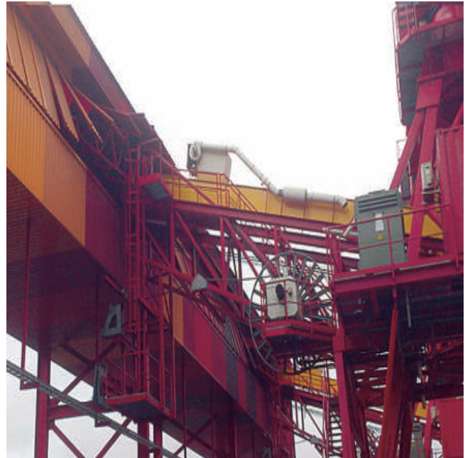
Trasferencia de descargador continuo a cinta carenada y con aspiración.
