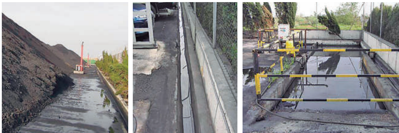
Recogida perimetral de agua de lluvia y riego en parque de graneles para su reutilización como agua de riego. Detalles de la conducción superficial de agua sin partes enterradas y de la balsa de decantación primaria
