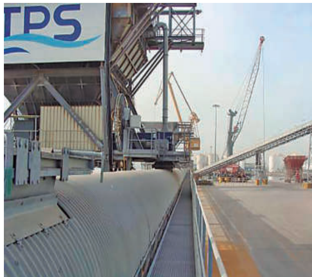
Cinta paralela a muelle con registros para acoplar el brazo de descarga carenado de una tolva.
