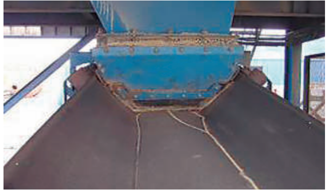
Un ajuste demasiado rígido acelera el deterioro de la cinta.
