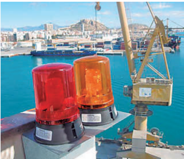
Indicadores luminosos en zona de operaciones en el Puerto de Alicante.
