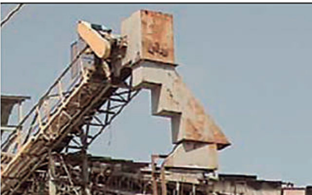
Tolva de transferencia en escalera
