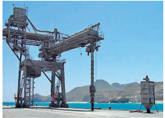
Descargador telescópico y filtro portátil para la carga de buques cisterna.
