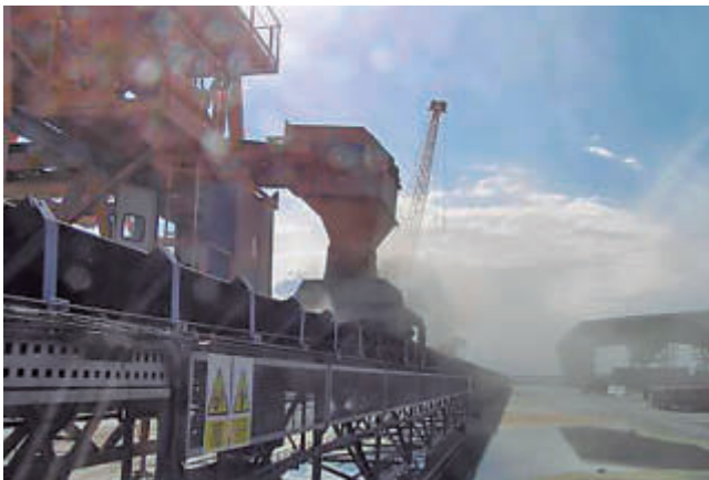
Un ajuste inadecuado del faldón de la tolva de descarga con la cinta puede provocar emisión en la transferencia
