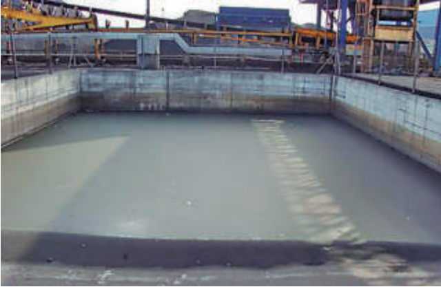
Piscina de decantación de aguas pluviales y riego recogidas en campos de carbón.
