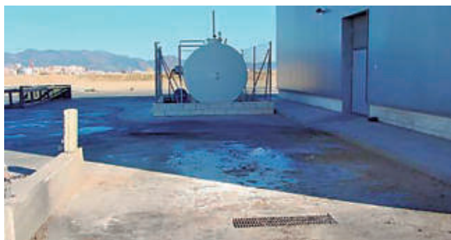
Área de lavado de maquinaria con recogida y tratamiento del agua por decantación y separación de hidrocarburos
