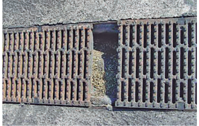
La protección de arquetas durante la operativa evita el cegado de las mismas por posibles derrames
