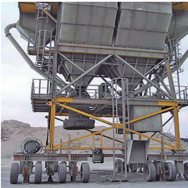
Tolva con aspiración en boca y en manga de descarga.
