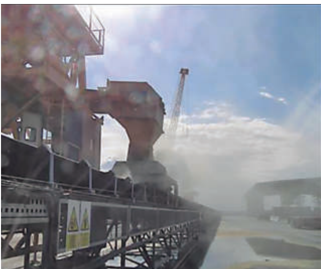
Un mantenimiento deficiente incrementa las emisiones y derrames en las operaciones.
