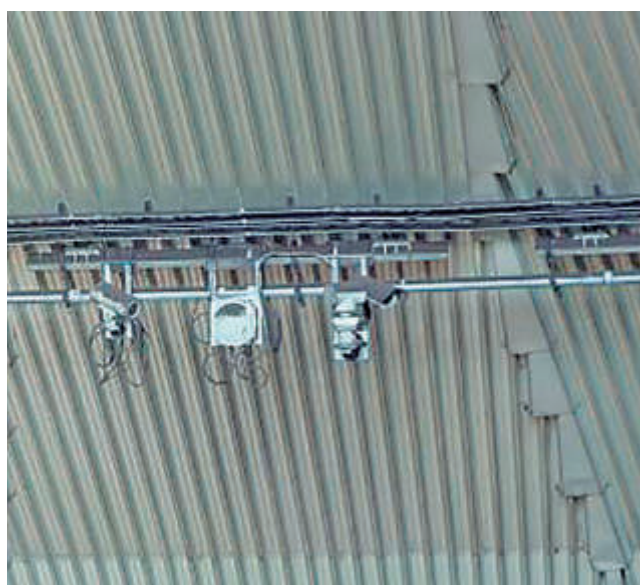
Cámaras termográficas informan de posibles autocombustiones.
