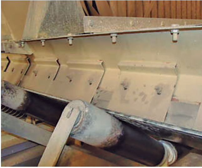
El mantenimiento de los faldones en los encauzadores de cintas es esencial para evitar derrames y emisión de polvo.
