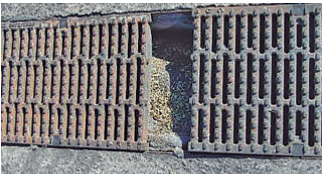
Cereales y materiales que fraguan pueden atascar arquetas y conducciones si no se protegen durante la operativa, o no se limpian.
