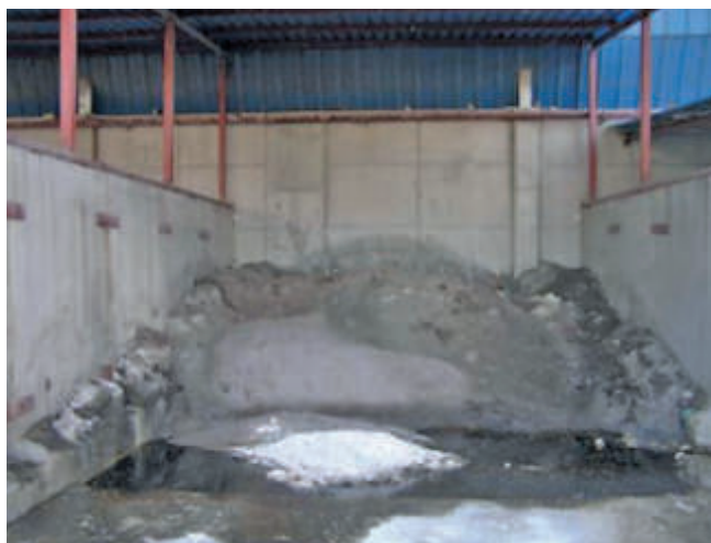
Almacenamiento de mercancía barrida en muelle y viales. Los derrames de mercancía incrementan los costes de limpieza y gestión de residuos
