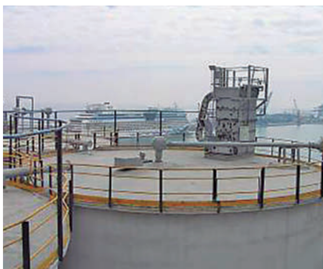
Filtro de partículas en la salida de aire de un silo cargado mediante sistemas neumáticos.
