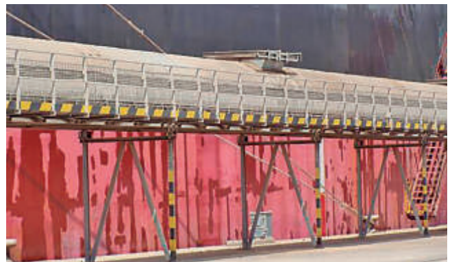
Sistema de cintas elevado sobre borde del cantil, hace compatible el uso eficiente del muelle, con las tareas de mantenimiento.
