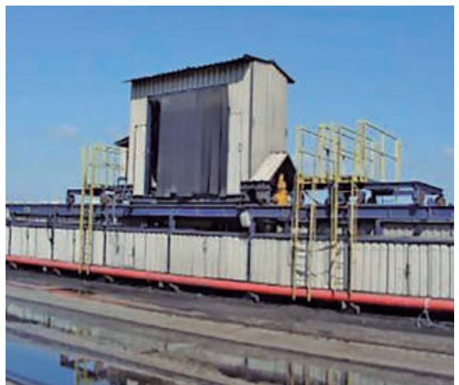
Estructura carenada y con cortinas para apantallar transferencia de tolva a cinta
