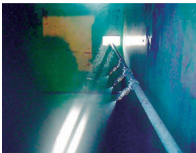
Pulverización de agua con inyectores
