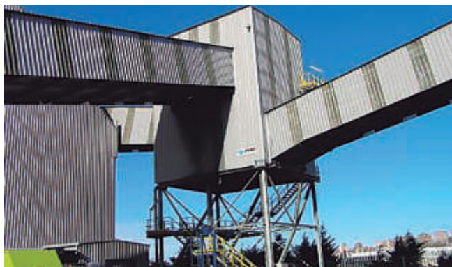
Cintas y transferencia entre cintas totalmente carenada.
