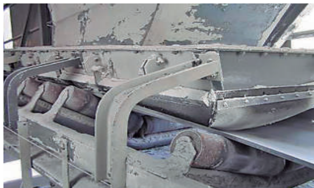
Trasferencia entre cintas mediante tolva y encauzador en recinto carenado.
