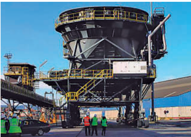
Transferencia entre tolva ecológica y cinta mediante mesa de descarga.
