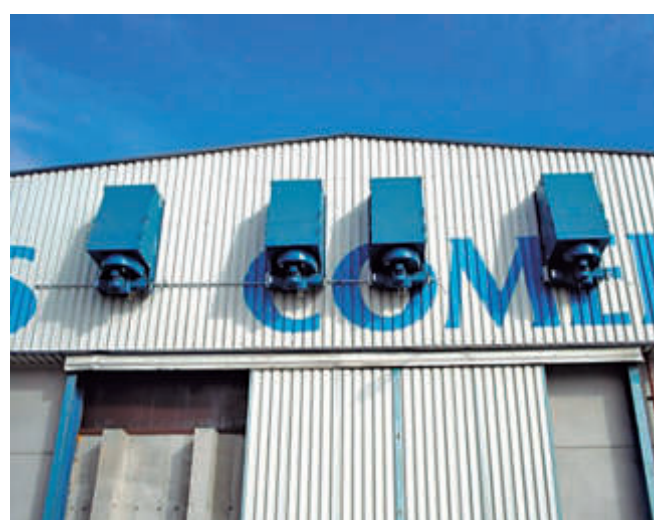
Aspiración y filtrado actuando en un almacén horizontal.
