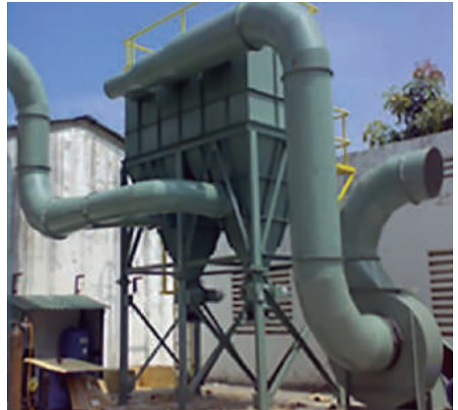
Detalle de la unidad de filtrado y extracción de un filtro centralizado
