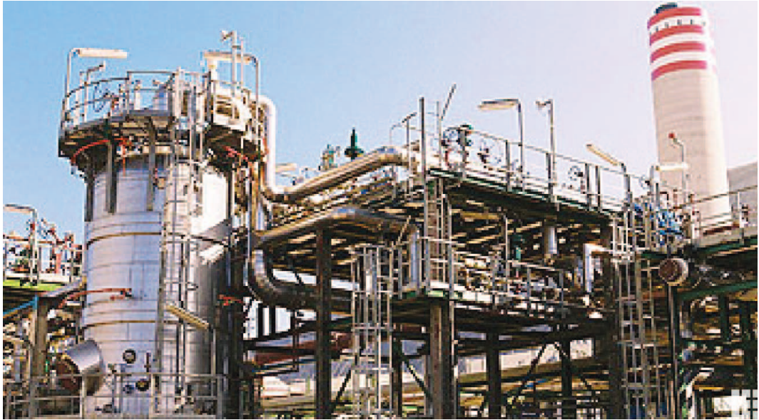
Figura 30. Último relicuador instalado en España (Reganosa, 2007).
